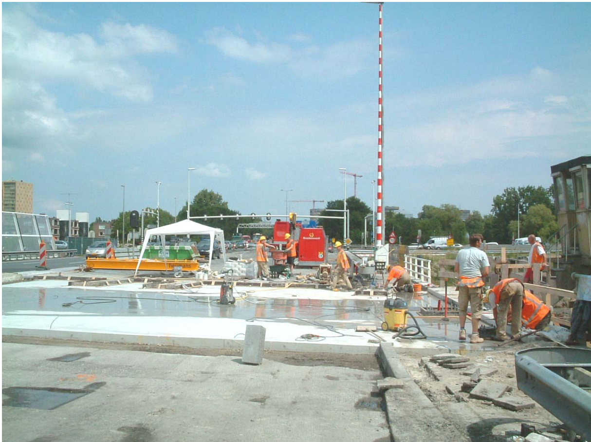
Werk aan de weg, hier wordt de Julianabrug waar de A28 en de A7 elkaar ontmoeten, van een nieuw brugdek voorzien.
